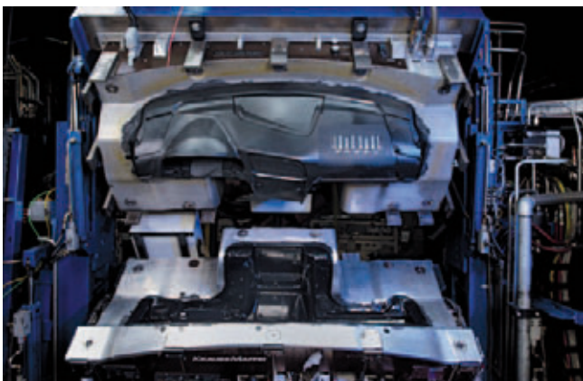
BILD 4 Die Schaumanlage im geöffneten Zustand
